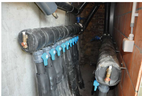
Fig. 2 In een technische ruimte zien we twee collectoren waarop de 18 putten zijn aangesloten. Dans un espace technique on aperçoit le raccordement des 18 puits sur deux collecteurs.
